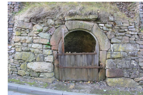
Eingang Hangkeller mit baufälliger Tür (Okt. 2012)
