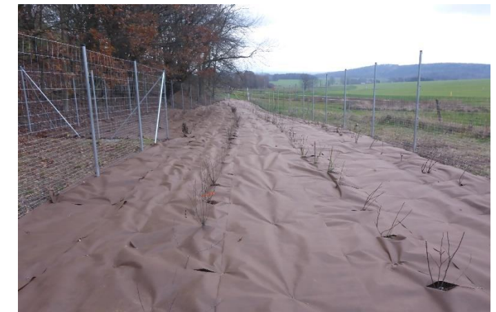
Herstellung AT 25, Pflanzgruppe 1 (ca. 500 m 2 ) im Dezember 2020; diverse vorbereitende Arbeitsgänge und vollflächige Abdeckung mit Pflanzvlies aufgrund des Vorkommens von Riesenbärenklau
