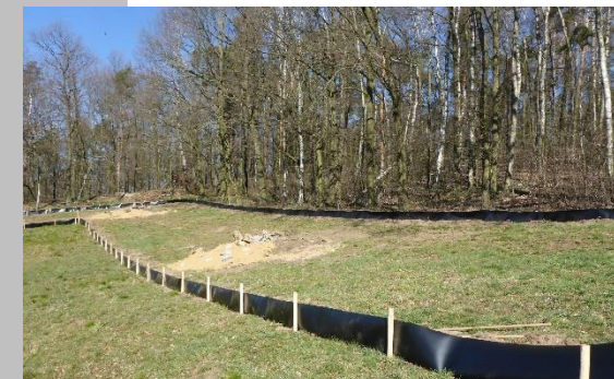
Aufbau RSZ bei AT 12.1, südseitig des Gickelsberges
